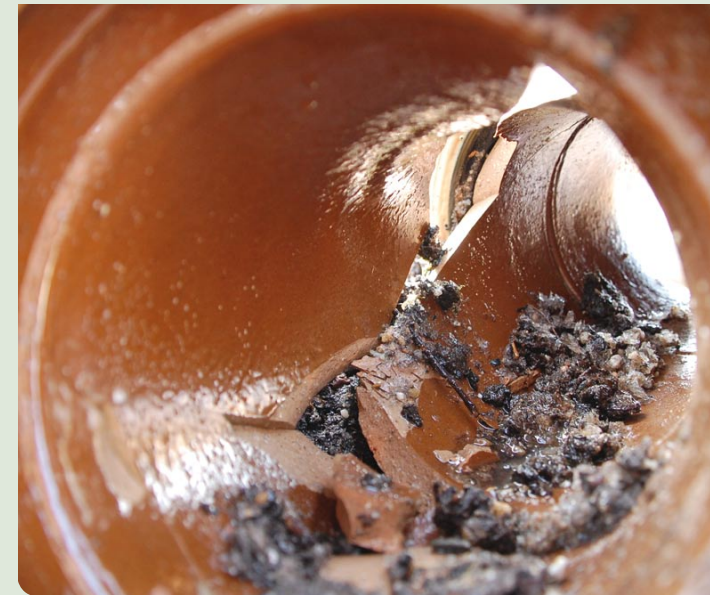
Abwasserleitung in Scherben gebrochen
